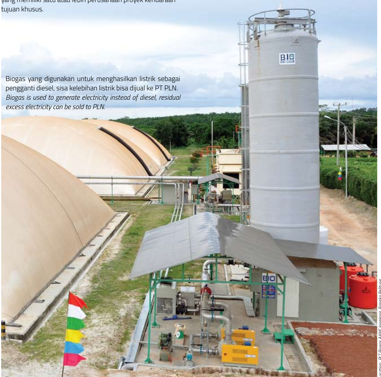
Location: PT Biogas AANE Imbang, Bangka Belitung
