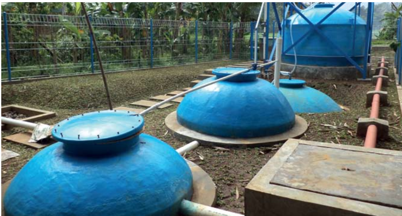
Pengelolaan biogas limbah dengan digester. (Lokasi : Banyumas Jawa Tengah). Management of waste using biogas digester (Location in Banyumas, Central Java)
